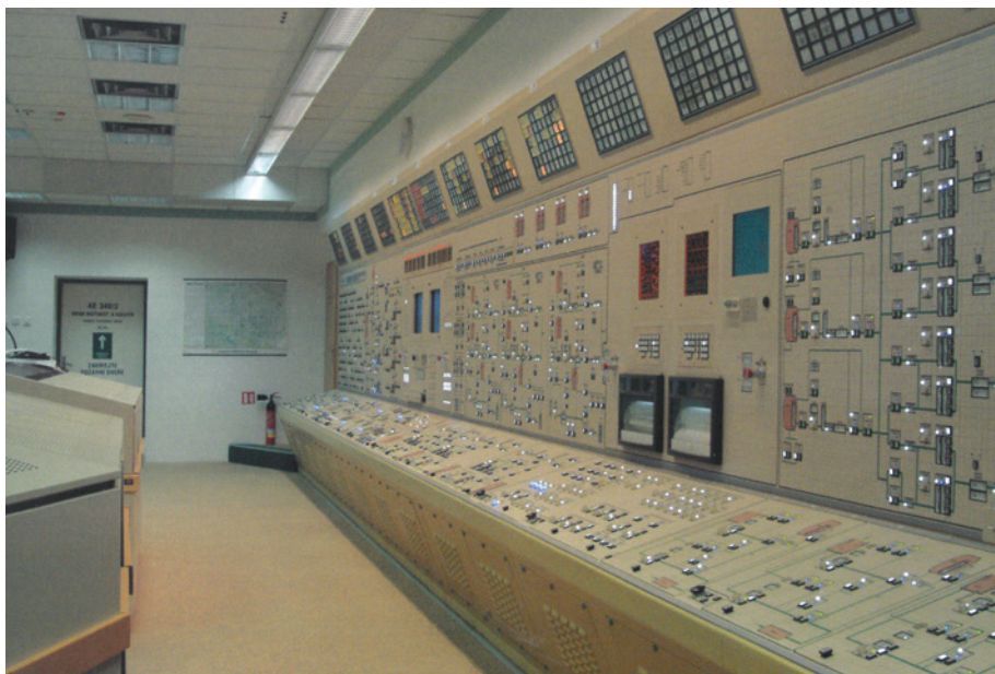
Obr. 9 Centrální řídicí pult elektrárny
