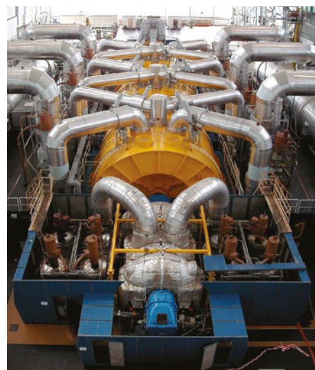
Obr. 8 Celkový pohled na turbogenerátor 1 000 MW – výroba Škoda Plzeň
