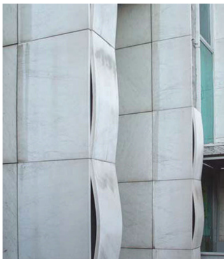
Obr. 7 Porušený mramorový obklad na budově Zagrepčanka v Zagrebu [6]
