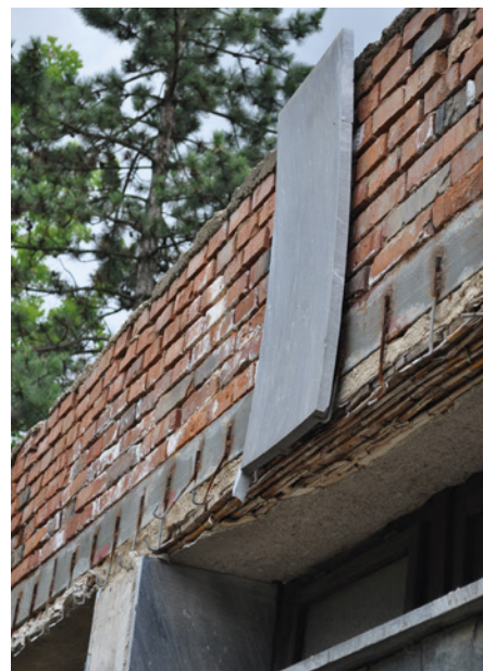
Obr. 10 Detail atiky obložené mramorem s výrazným projevem obloukové deformace (foto: Josef Chybík)
