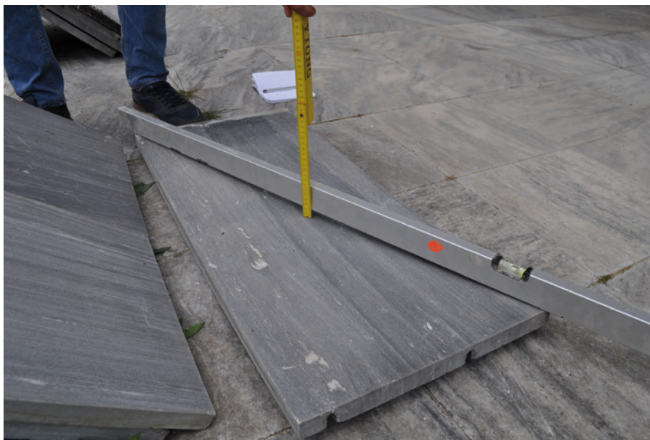
Obr. 11 Měření amplitudy na deformované mramorové desce z atiky smuteční síně v Brně-Židenicích (foto: Josef Chybík)
