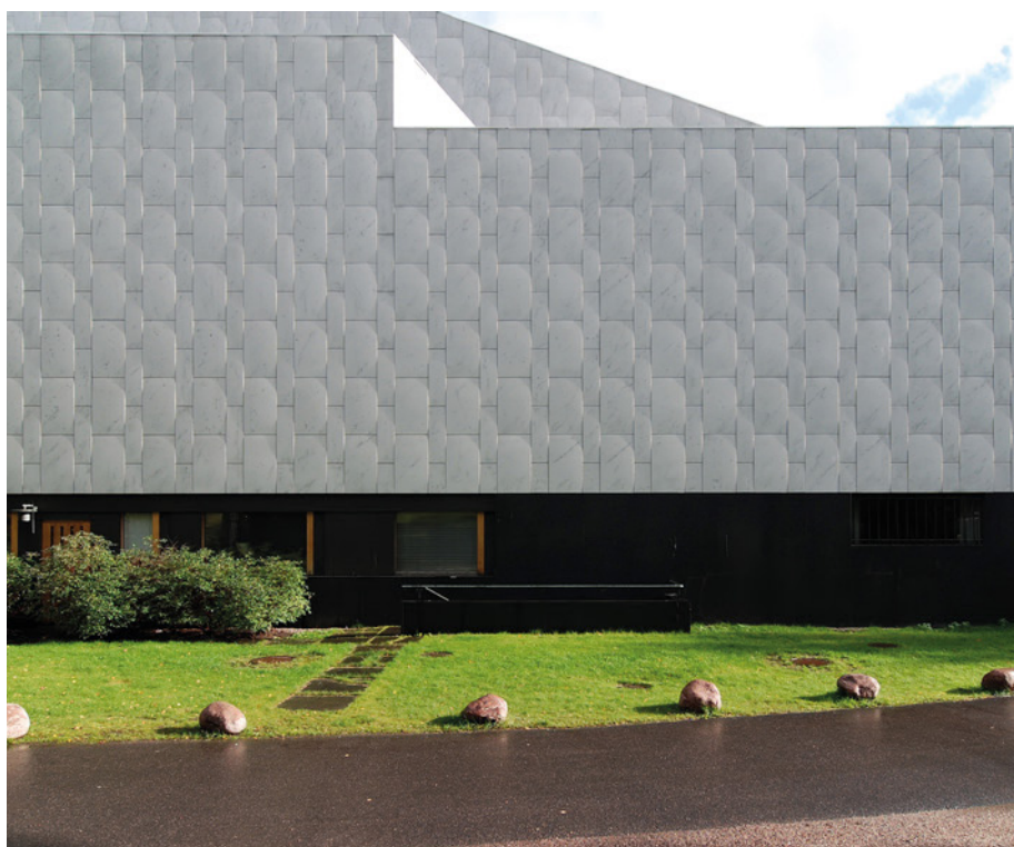
Obr. 1 Hala Finlandia v Helsinkách s formovanými deformacemi obkladových desek instalovaných při první opravě (foto: Petr Šmídek)
