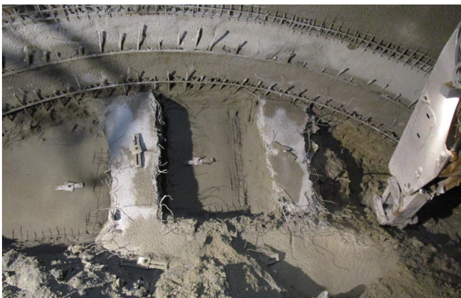
Obr. 10a Otevírání a zajišťování čelby po částech při zhoršení horninového prostředí (jižní trouba)
