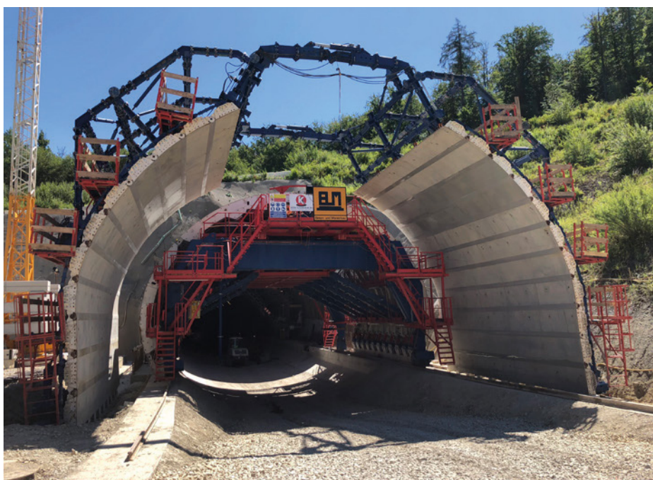
Obr. 19 Forma pro betonáž klenby s pojízdným bedněním pro betonáže v hloubeném úseku
