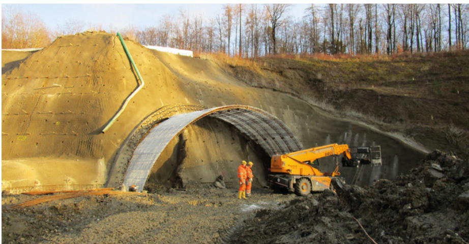
Obr. 8 Předstíték jižní tunelové trouby v západním zářezu (nad ním jsou patrné trhliny vzniklé pohybem svahu)
