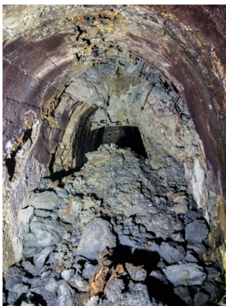
Obr. 15 Rozsáhlý zával na čelbě horní štolý č. X
