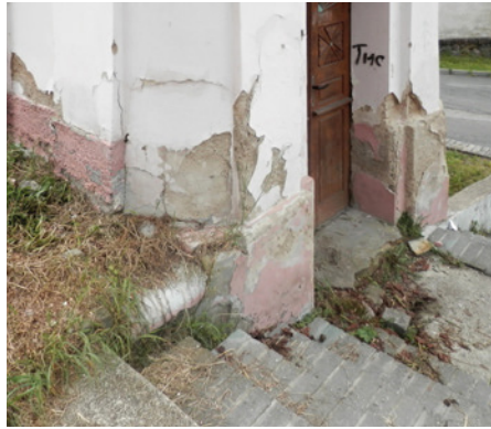
Obr. 2 Soklové partie kaple poškozené vlivem ataku zemní vlhkosti
