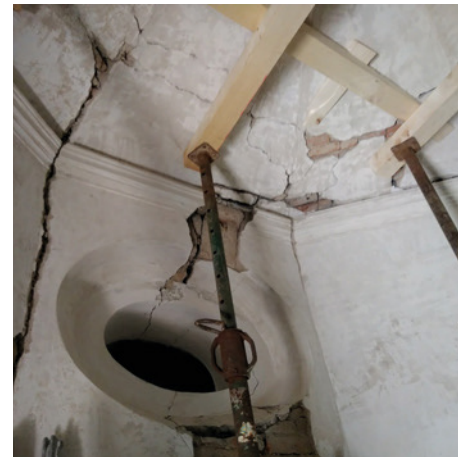
Obr. 5 Provizorní podepření uvolněné klenby
