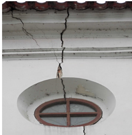
Obr. 4 Statická porucha – potřáhané zdivo kaple vlivem pohybů v podzákladí
