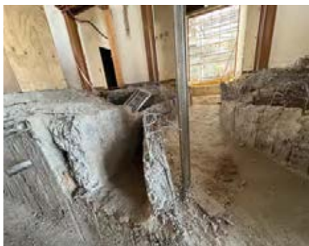
Obr. 5 Otevřené instalační kanály před sanací
