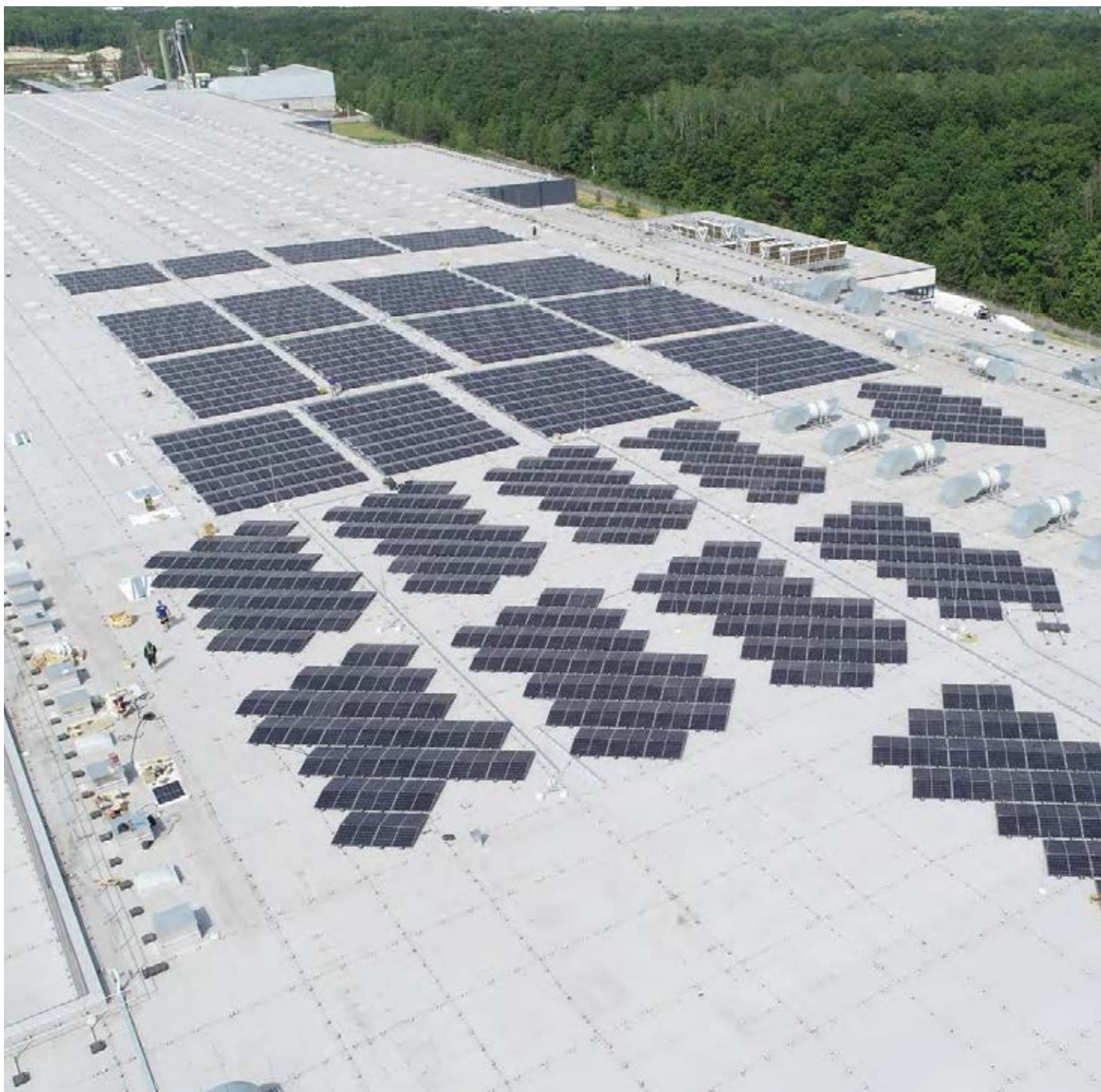
Obr. 1 Fotovoltaická elektrárna na ploché střeše (zdroj: archiv Lidl Česká republika s.r.o.)
