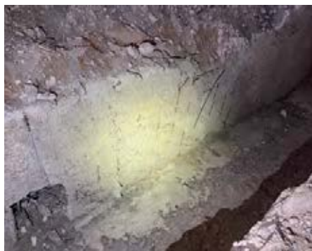
Obr. 6 Typický stav instalačních kanálů po očištění
