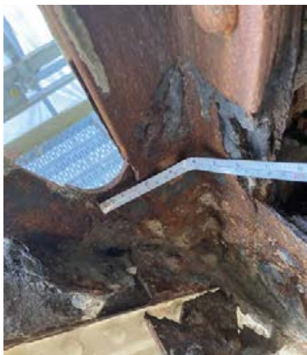
Obr. 11 Stav styčnicku před sanací (foto: Excon a.s.)
