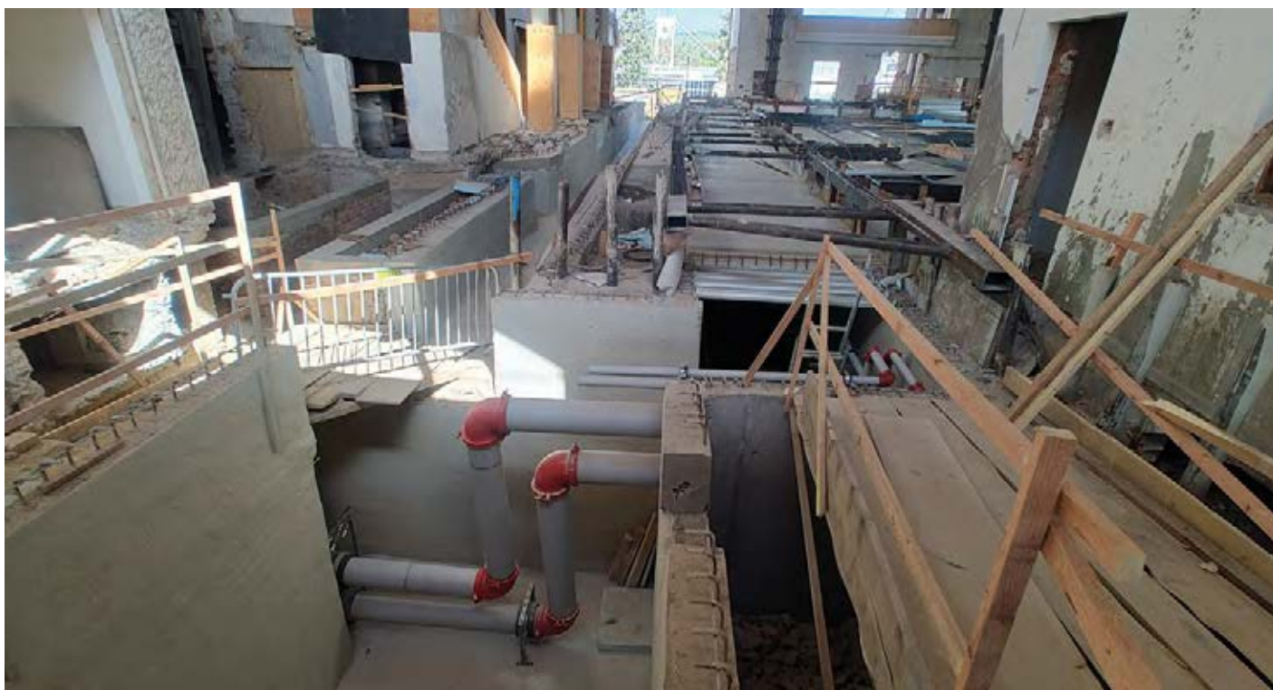
Obr. 7 Vpravo nový kolektor, vlevo původní instalační kanály v pravém křídle
