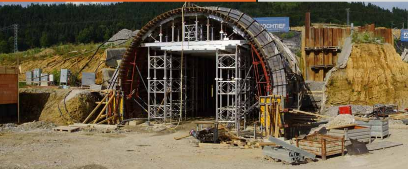
▲ Obr. 1. Západní portál, betonáž portálového bloku a definitivní ostění tunelu pod želvou
